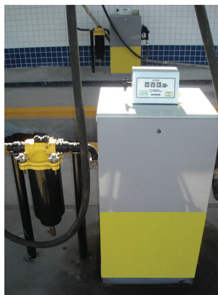
Instalação em Transportadoras
