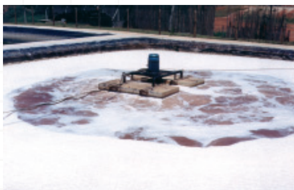
Exemplo de instalação: Lavanderia - 10CV (Indaiatuba-SP)
