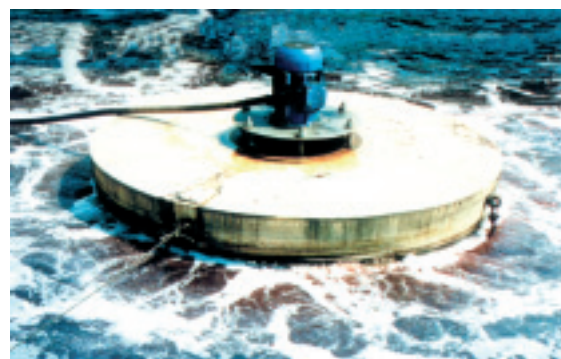
Exemplo de instalação: Tinturaria - 15CV (Cajamar-SP)
